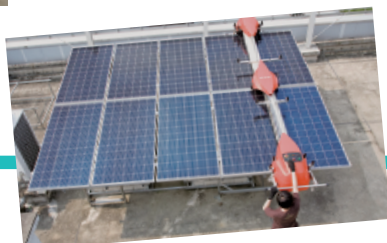
Type1をベースにした、メガソーラー（大規模太陽光発電所）向けの大型機Type2。現在、インドでモニター試用されています。
